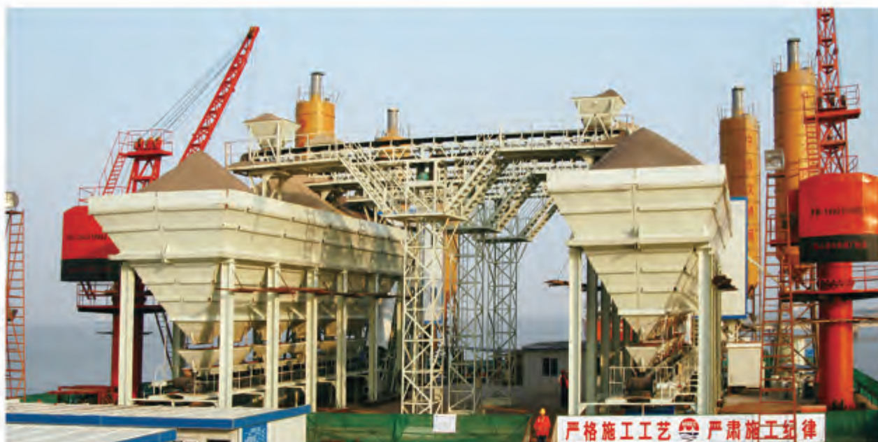
▲ 中铁大桥局水上平台特殊配料机
