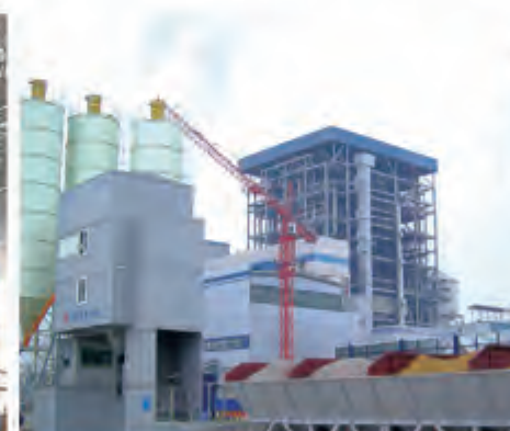
电厂专用搅拌站
