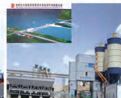
水工专用搅拌站
